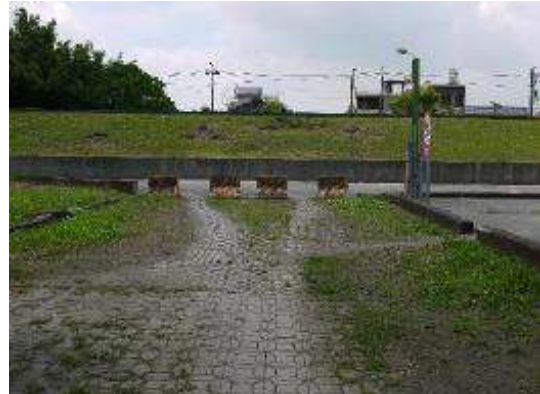
鋪面沉陷顛簸
